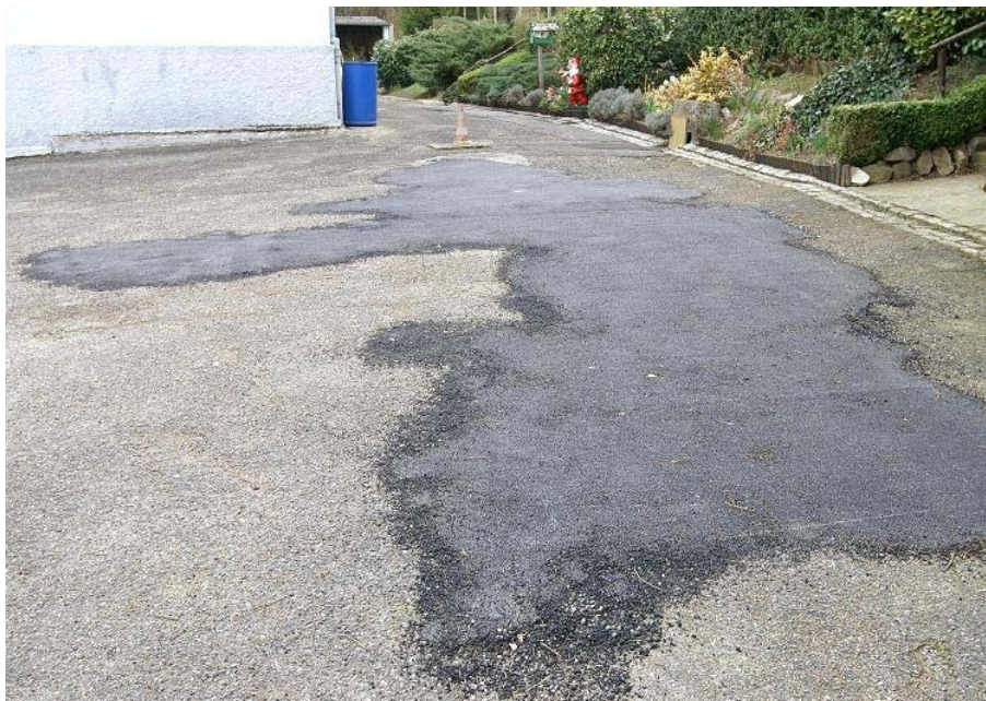
Bitume obtenu gratuitement sur une fin de chantier pour combler des trous.
